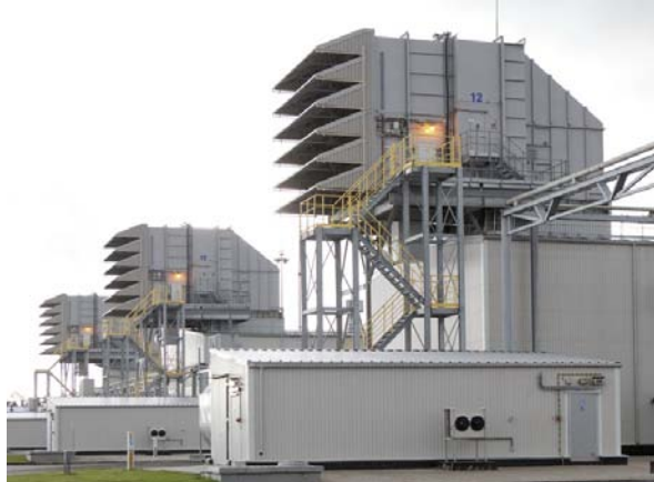
Рис. 5 КВОУ AAF ASC для газовой турбины Rolls Royce. Компрессорная станция «Портовая» магистрального газопровода «Северный Поток», г. Выборг Ленинградской области.
